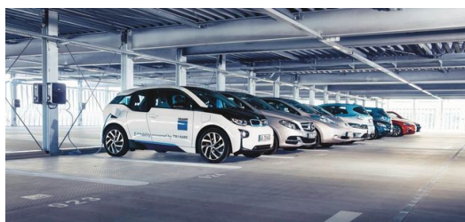
Stazione di rifornimento elettrica: a Ditzingen 86 punti di ricarica sono a disposizione dei dipendenti nel parcheggio multipiano dell'azienda. TRUMPF sta anche elettrificando la propria flotta di veicoli.
