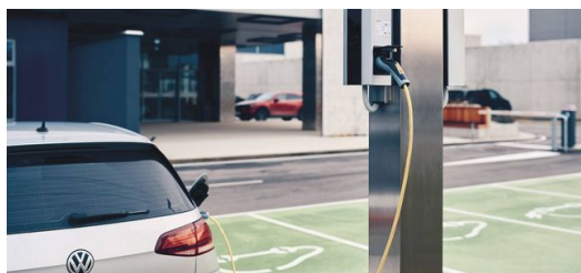
Conception durable : des cellules solaires sur le toit de l'usine alimentent les bornes de recharge de la flotte de l'entreprise.
