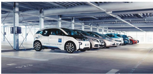
Estación de carga eléctrica: En Ditzingen, los trabajadores tienen a su disposición 86 puntos de carga en el aparcamiento propio de la empresa. TRUMPF también está electrificando su flota de vehículos.
