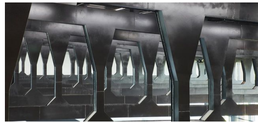
Der Skywalk ist Teil der frei tragenden Deckenstruktur aus Stahl, die von einem TRUMPF Kunden in Atlanta gefertigt wurde. Bild: Steve Hall © Hall+Merrick
